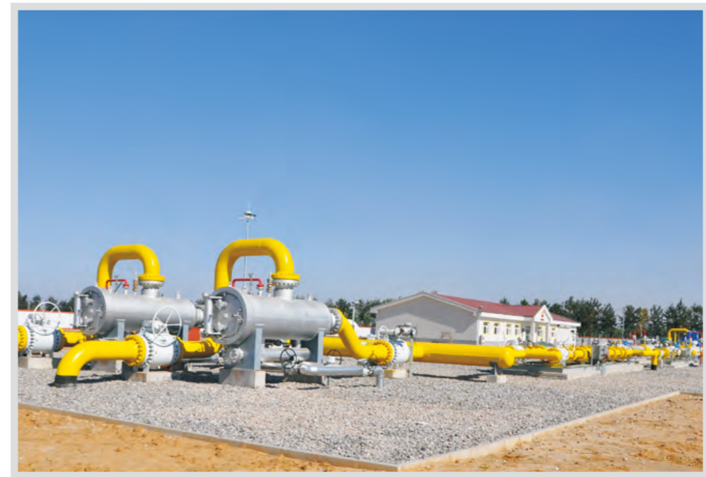
甬台温成品油管道
