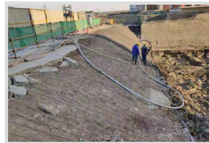
景芳三堡单元JG1206-10地块安置房 工程项目降水及边坡支护工程
